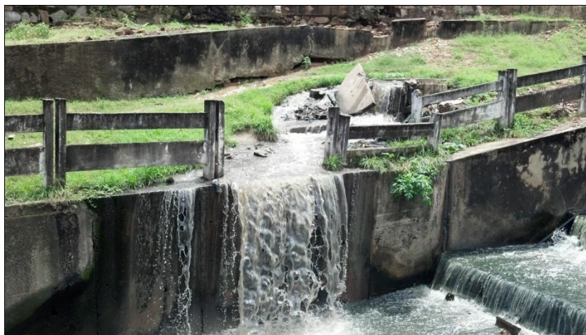
Figura 157. Lançamento de esgotos in natura no Riacho das Quintas
