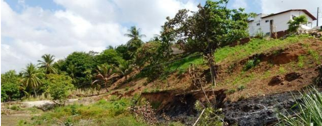
Figura 44. Erosão em vertentes de tabuleiro da ZPA-08 com alto risco e intenso processo erosivo já instalado.
