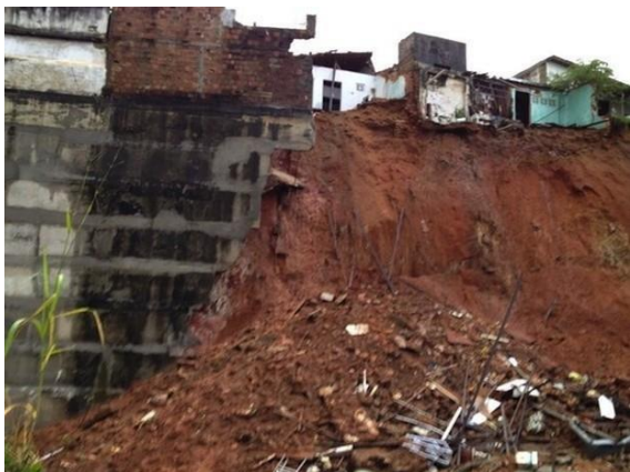
Figura 69. Colapso do muro de arrimo na comunidade do Jacó (imagem do dia 14 de junho de 2014), Zona Leste, no bairro das Rocas.
