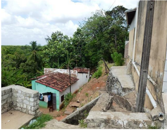
Figura 42. Erosão em vertentes de tabuleiro da ZPA-08 com alto risco e intenso processo erosivo já instalado.
