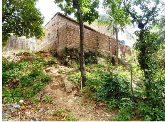
Figura 43. Erosão em vertentes de tabuleiro da ZPA-08 com alto risco e intenso processo erosivo já instalado.
